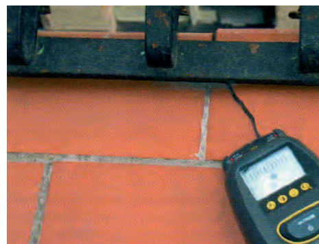
Mediante el detector empleado queda confirmada la existencia de metales bajo la grieta
