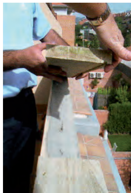
En este caso, el adhesivo empleado no era el adecuado
